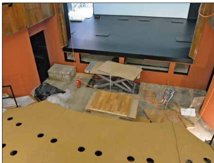
Die verschiebbare Bestuhlung des Parketts ermöglicht die Erschliessung einer grossen Stehfläche. In der Bildmitte ausserdem die neue Hebebühne. Bilder: David Kocher
